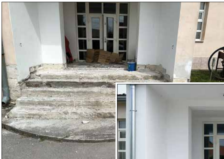
■ Schody na kultúrnom dome boli v zlom stave
