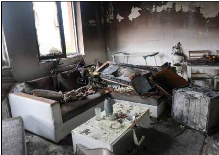
■ Pri požiari bol kompletne poškodený – vyhorelý jeden byt
